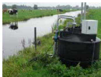
Pompput t.b.v. waterinfiltratiesysteem
